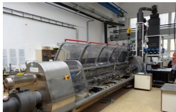
Obr. 6 - Celkový pohľad na národný etalón prietoku a pretečeného množstva vody (NE 021/99)
